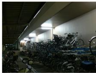
駐輪場の照明
