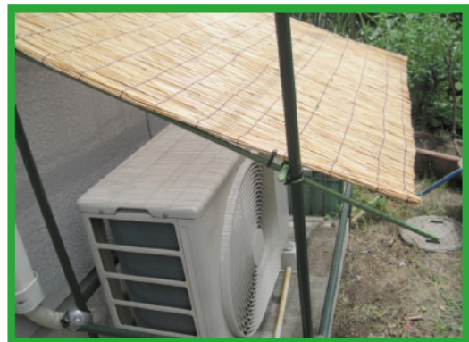
(室外機の日よけ)
